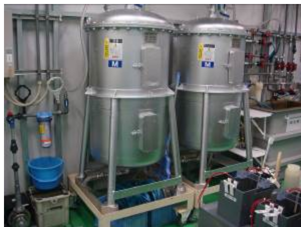
純水製造装置
